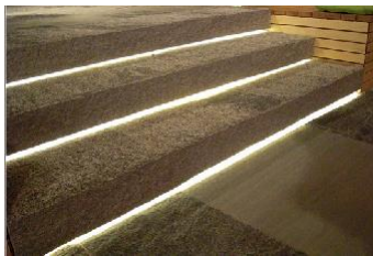
Treppenbeleuchtung mit LED-Linearleuchte
